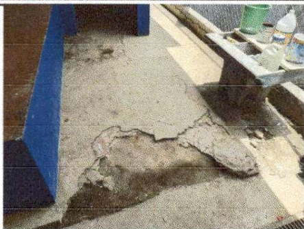
FOTO 1: Sustrucción de piso de torta de concreto
