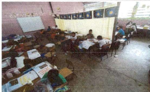
FOTO 3: Sustrucción de cemento liquido por piso cerámico
